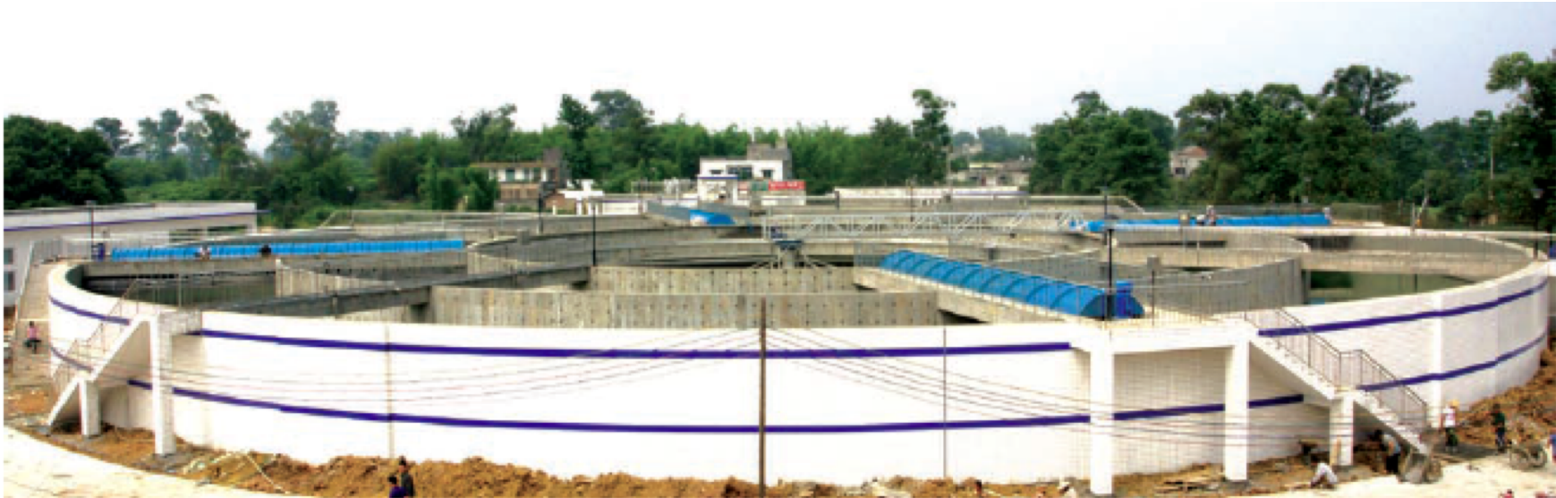
平安污水处理厂一体化氧化沟
